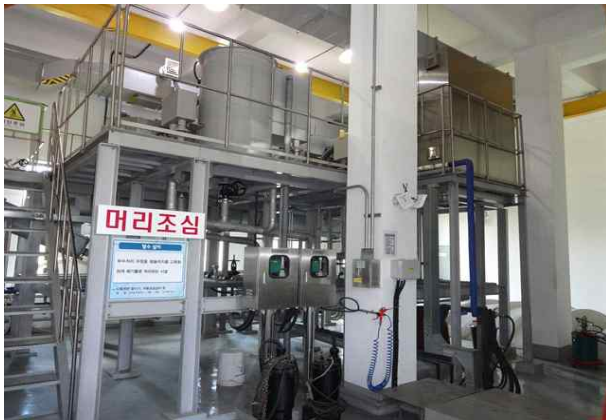
내부 탈수설비 전경
