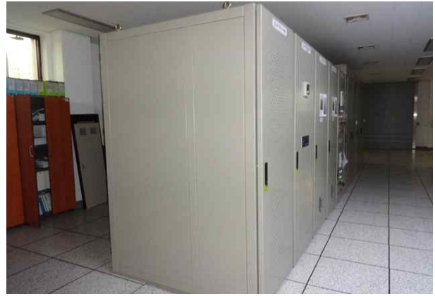
내부 수배전실 전경
