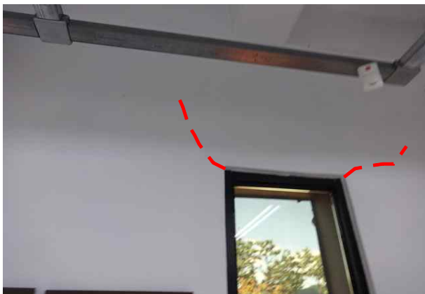
내부 벽체, 마감 균열 (CW=0.2mm, L=1.0m, 2EA)
