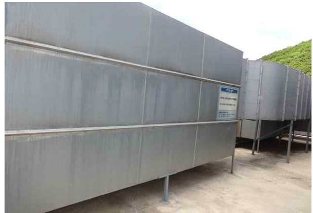
내부 2차탈취설비 전경
