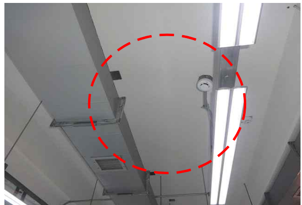
내부 천정, 마감 망상균열 (A=5.0m×1.0m)
